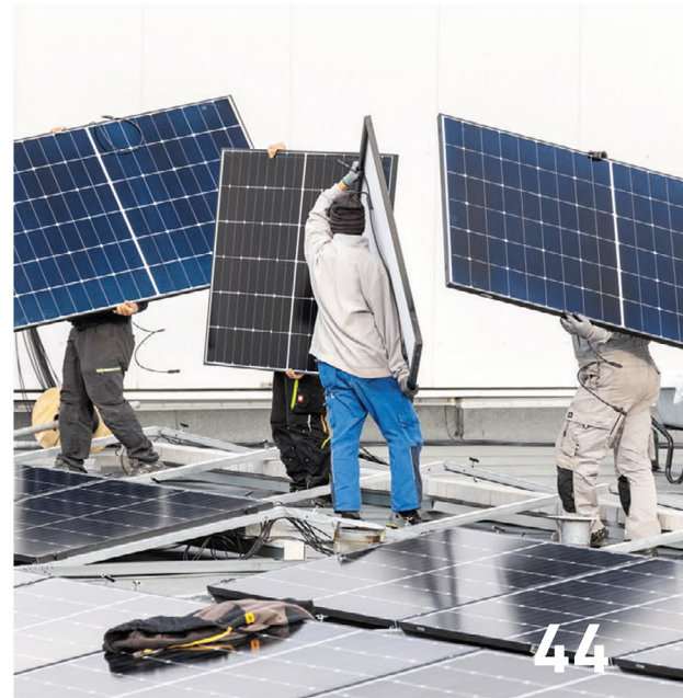
Solarboom: Deutschland erreicht Rekorde beim Bau von Photovoltaik-Anlagen. Für die Ziele der Bundesregierung braucht es aber noch mehr Tempo.
