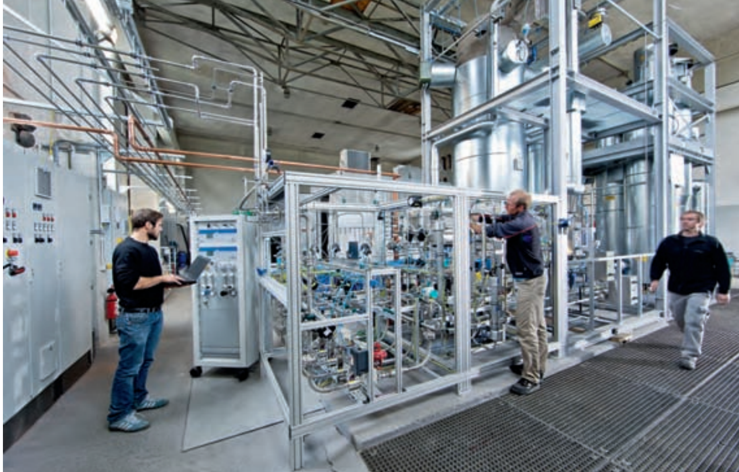
Strom zu Gas: Audi geht unter die Kraftstoffproduzenten. Mit der Power-to-Gas-Anlage wollen die Ingolstädter genug Windstrom in Methan umwandeln, um damit ihre gesamte Gasfahrzeugflotte zu betreiben.
