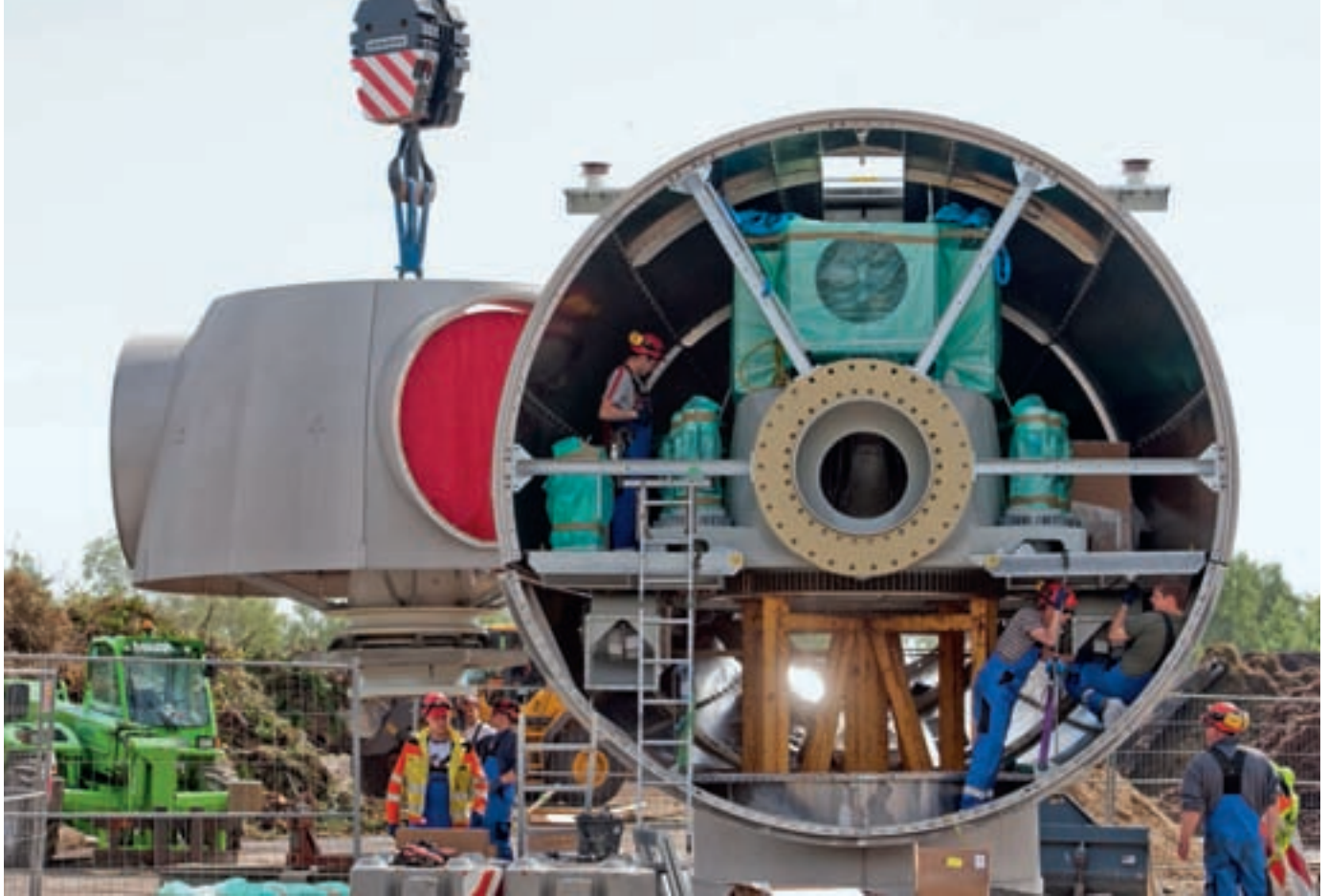
Regenerative Energiezentrale: Die Windmühlen auf dem Osnabrücker Piesberg wurden 2009 repowert.
