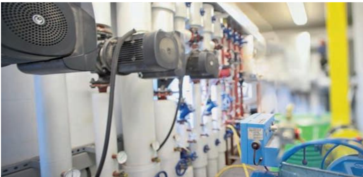
Leitungsgewirr: Auf sieben Bar verdichtet strömt das Gas durch die Aufbereitungsanlage.
