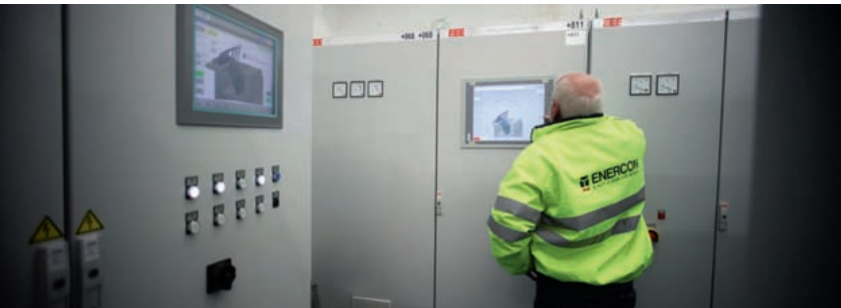
Zentrale im Untergrund: Das eigentliche Kraftwerk liegt tief unter der Erde. Vom „Krafthaus“ aus überwachen der Technische Betriebsleiter Karl Ihmels und sein Team die Anlage.
