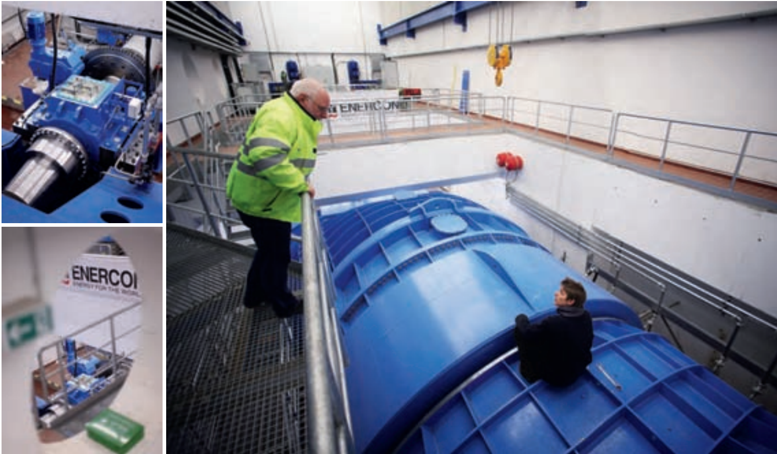
Windtechnik im Herzen: Im Inneren des Wasserkraftwerks sitzt ein Generator von Enercon, Modell E 82, wie er auch in Windmühlen Verwendung findet. Zwei Fünf-Megawatt-Turbinen treiben den Generator an.
